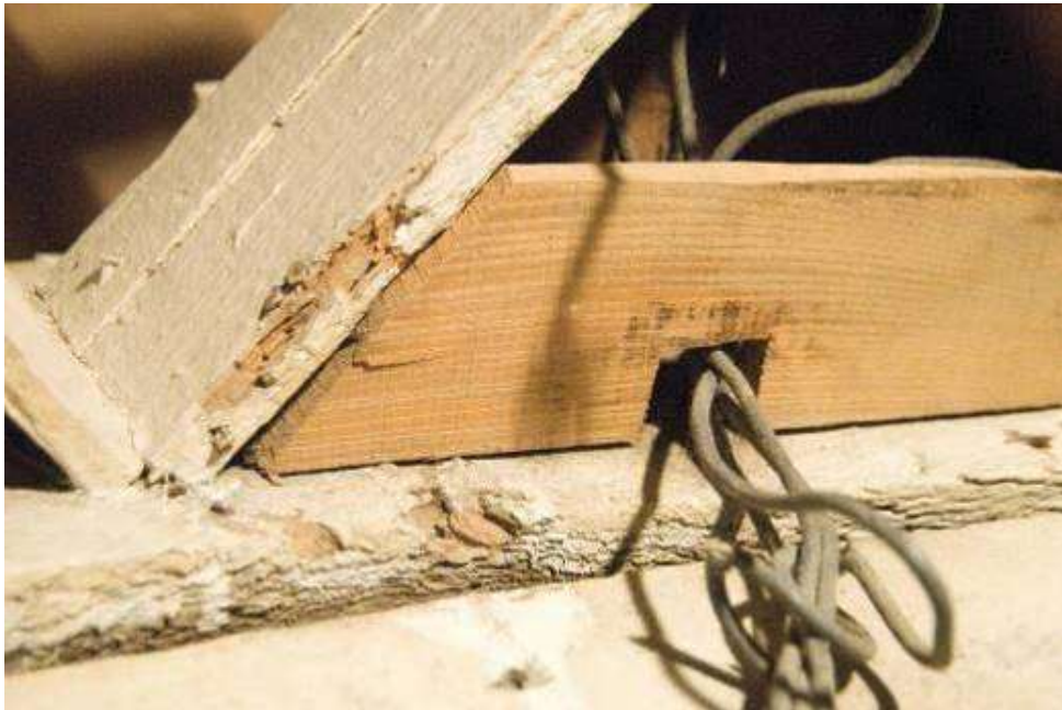
Rovarkárosítás következtében meggyengült és kitört rész a tetőn.
