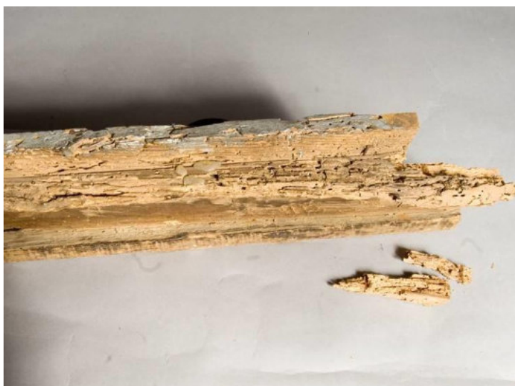
A bábmozgató folyosó a homloklap hátoldalához kapcsolódó rovarrágott faelemének állapota
